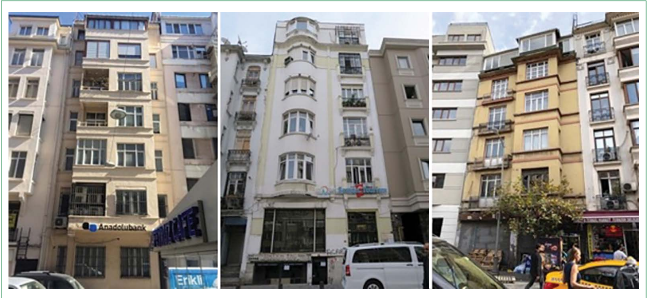
Şekil 30. Özgün cephe organizasyonu okunabilmesine rağmen kaçak kat eklemesi gözlenen yapı örnekleri (Yazarların arşivi, 2020).
