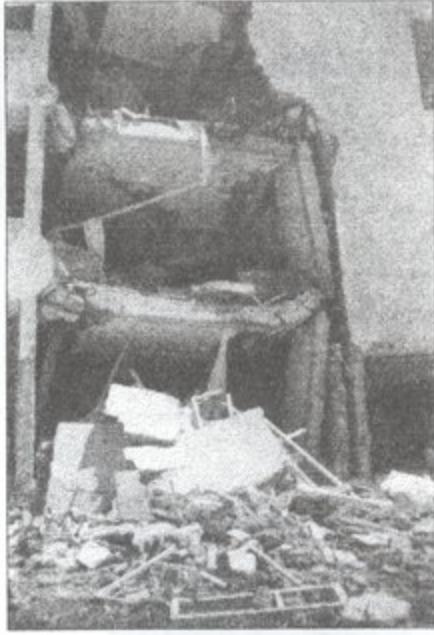
Şekil 4. Ağır hasar gören asmolen kat döşemeli yapı ve kolonlar
