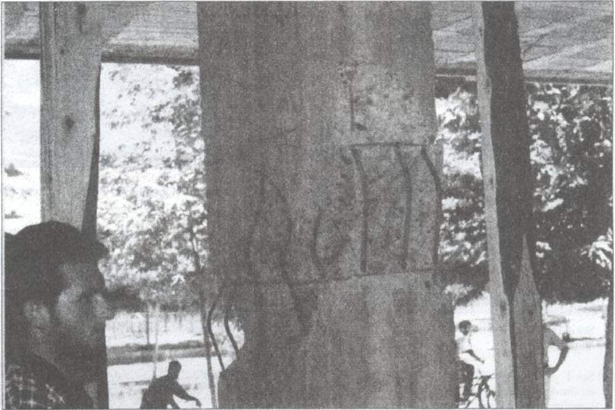
Şekil 12. Hasar görmüş kolon ve etriyeler
