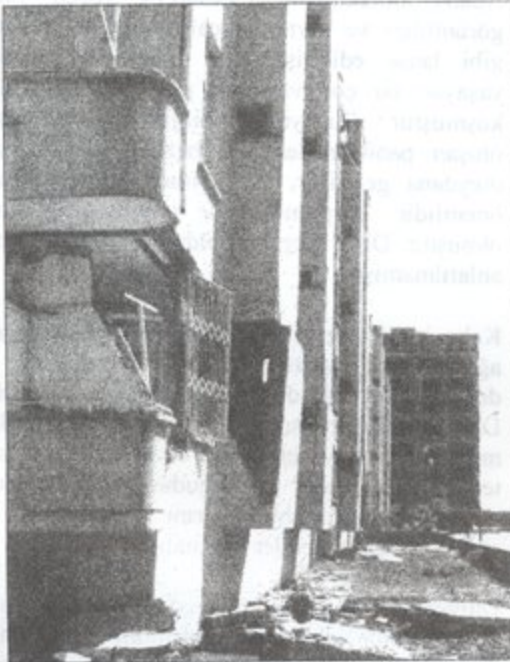
Şekil 29. Kapalı çıkmalar ve hasarlar
