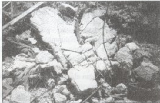
Şekil 9. Görevi yapıyı ayakta tutmak olan demir ve betonun ayrılmış hali
