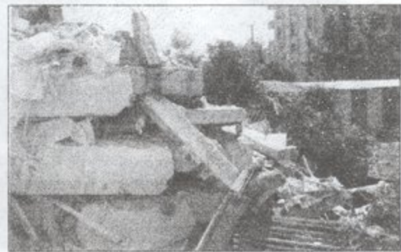
Şekil 18. Aynı kişilerce yapılan ve yıkılan başka bir yapı
