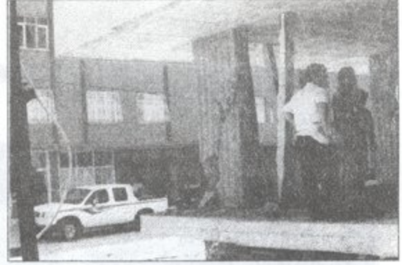
Şekil 11. Kolonda hasar ve ahşap kalaslarla destekleme gayreti
