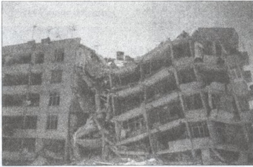
Şekil 2. Hasar görmüş ve yıkılmış olan çok katlı yapılar
