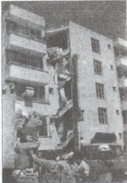
Şekil 6. Alt katı göçmüş ve ağır hasar görmüş yapıdan eşyaların çıkartılması
