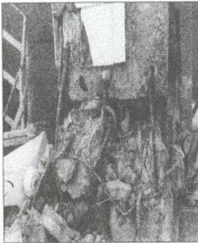
Şekil 24. Kalitesiz beton ve donatı işçiliğinin sonucu
