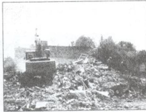
Şekil 20. Yıkılmış yapı ve arama çalışmaları
