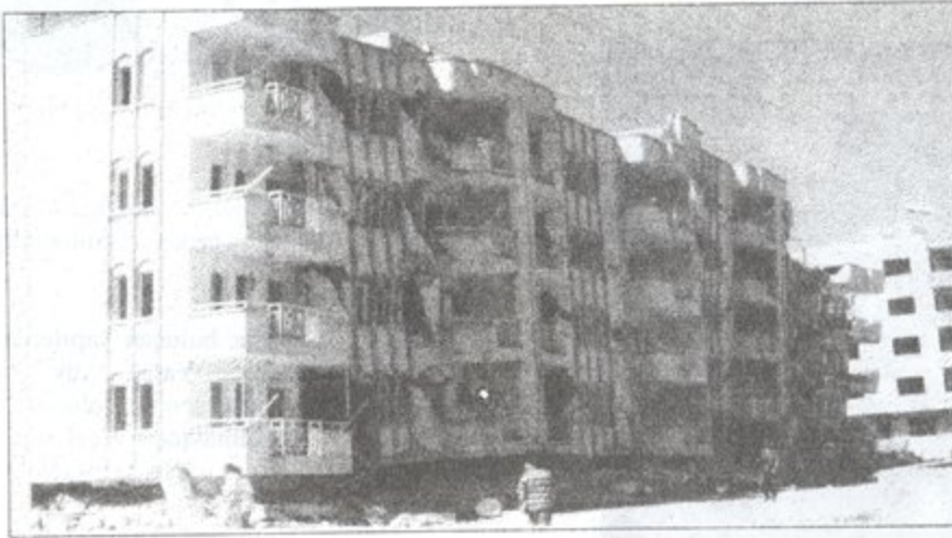
Şekil 21. Yumuşak kat ve hasarlar
