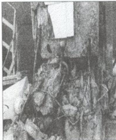
Şekil 24. Kalitesiz beton ve donatı işçiliğinin sonucu
