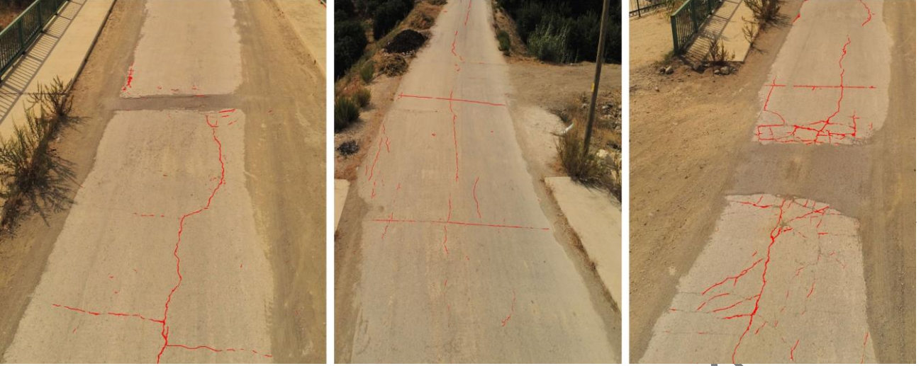
Şekil 3. Farklı bölgelerden seçilen yol kesitlerine ait çatlak segmentasyon sonuçları (kırmızı alanlar tespit edilen çatlaklar).
