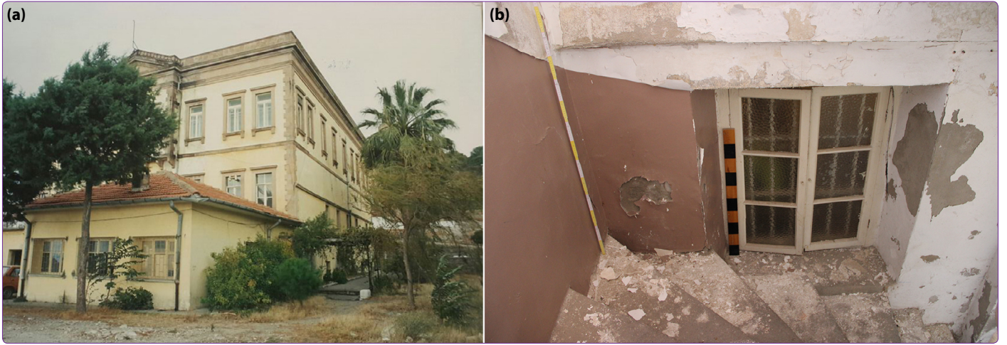
Şekil 23. (a) 1980'li yıllarda batı (deniz) cephesindeki özgün ahşap doğramalar (Balıkesir KVKBK Arşivi); (b) Günümüzde bodrum katta özgün ahşap doğrama.
