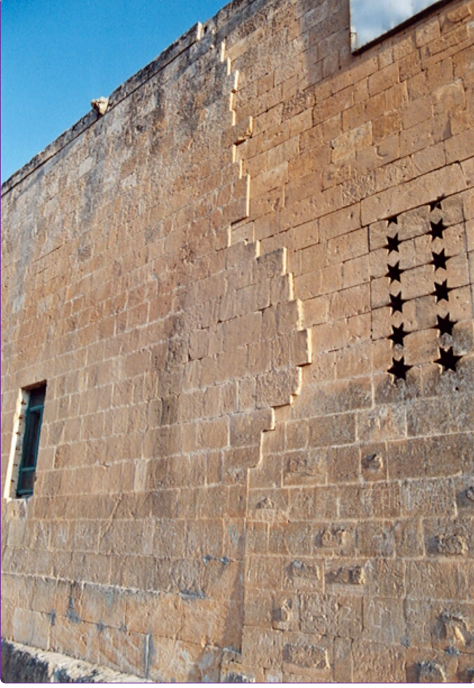
Şekil 26. Kuzey Cephesi – Tamirat İzleri, Duvardaki Yüzey Farkı (1993).
