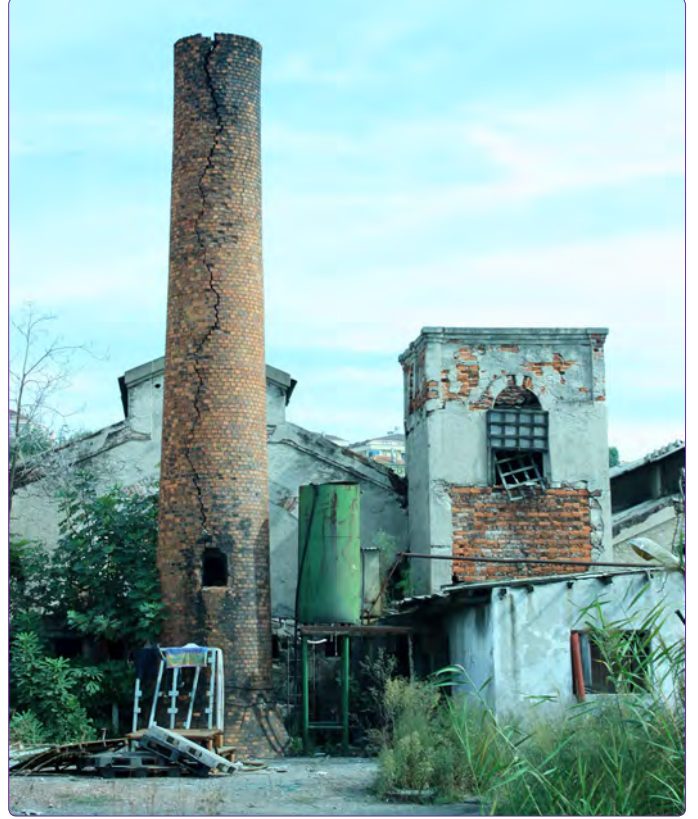
Şekil 29. Kuzeybatı cephesindeki baca ve kuledeki hasarlar (Kıraç arşivi, 2011).
