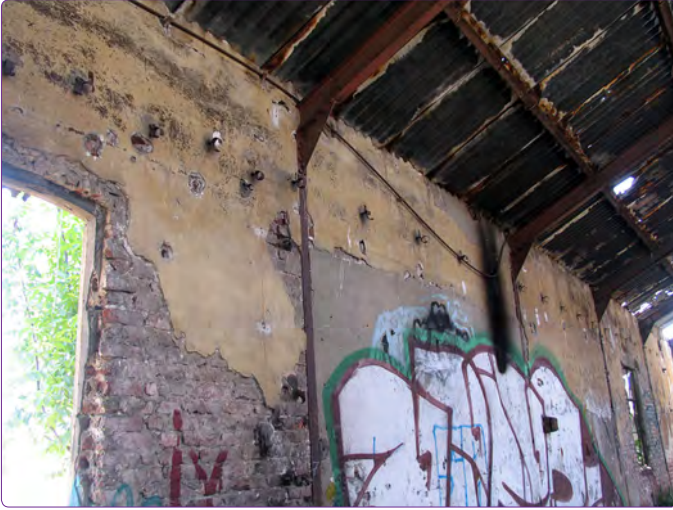
Şekil 27. 1. Bölüm iç mekân, taşıyıcı sistem ve duvarlardaki bozulmalar (Kıraç arşivi, 2011).
