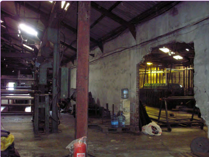
Şekil 28. Özgün duvardaki güncel hasarlar (Kıraç arşivi, 2011).
