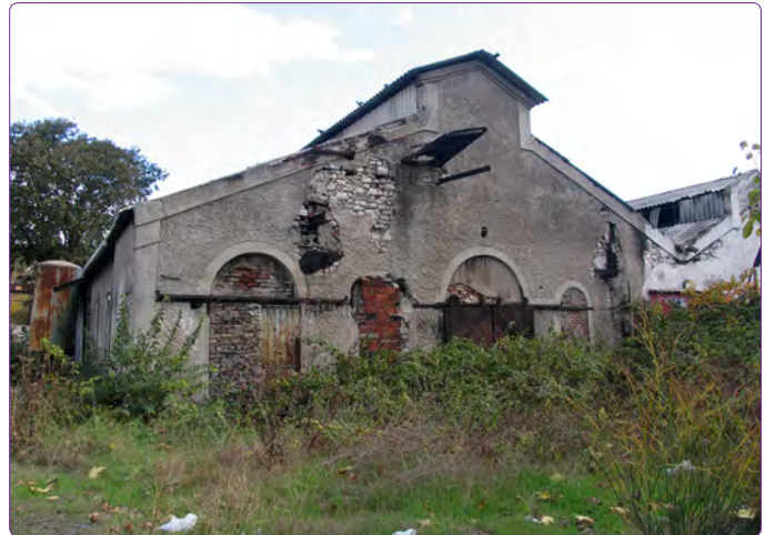
Şekil 30. 5. Bölümün Kuzeybatı cephesindeki bozulmalar (Kıraç arşivi, 2011).
