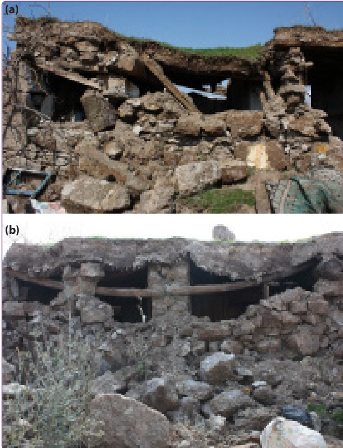
Şekil 20. (a, b) Toprak damlı hasarlı yapılar.
