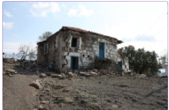
Şekil 22. Eğimli arazi üzerine yapılan hasarlı yapı.
