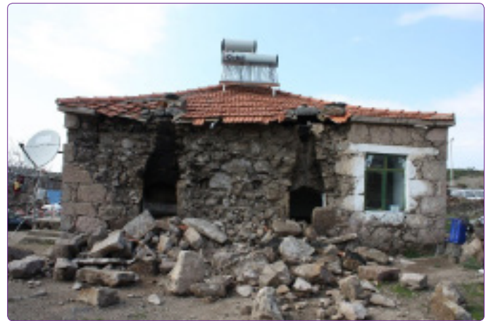
Şekil 26. Bacanın duvarda oluşturduğu hasar.
