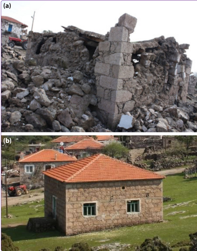
Şekil 15. Farklı dayanımlı harçlı yapıların durumu. (a) Düşük dayanımlı toprak harçlı bir yapıda oluşan hasar. (b) Çimento harç ile yapılan hasarsız yapı.
