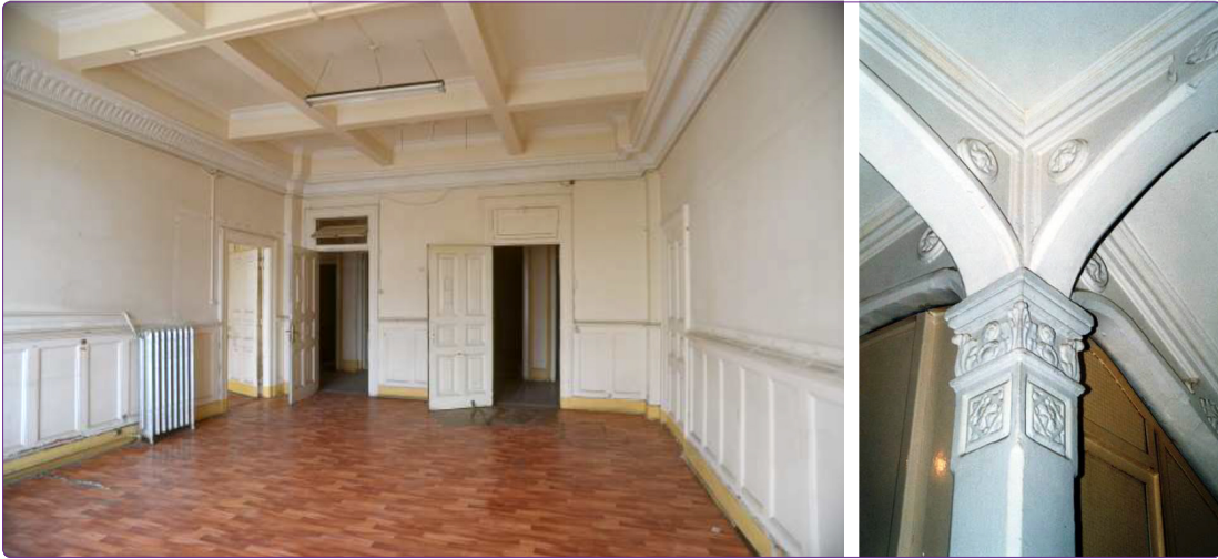
Şekil 21. Merkez Rıhtım Han, "Hennebique" betonarme taşıyıcı sisteme ait kolon, kiriş ve döşeme düzenleri (Uzay Yergün).
