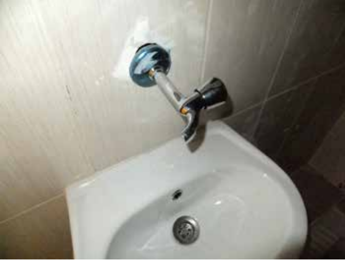
Şekil 17. Uygulamada yapım kalitesini düşüren işçilik sorunları.
