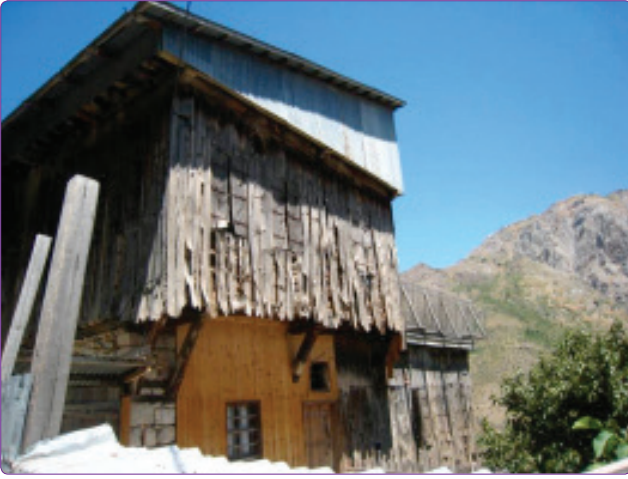
Şekil 8. Düşey ahşap kaplı cephelerde oluşan bozulmalar.
