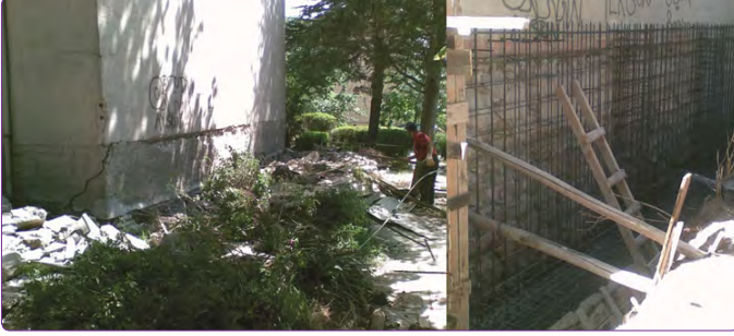
Şekil 4. Temelinde kaymalar olan yapılara ve güçlendirme çalışmalarına bir örnek. 87
