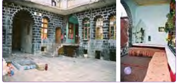
Şekil 26. Duvarın taş dokusunu bozan müdahaleler.
