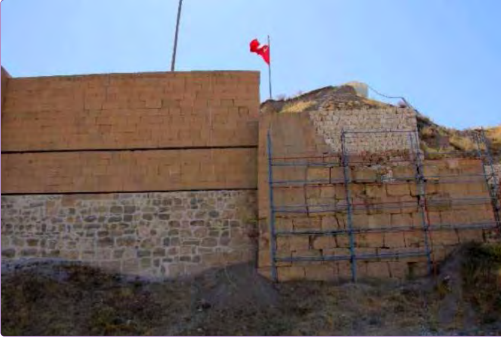
Şekil 19. Malzeme ve işçilik bakımından sorunlu rekonstrüksiyon detayı.
