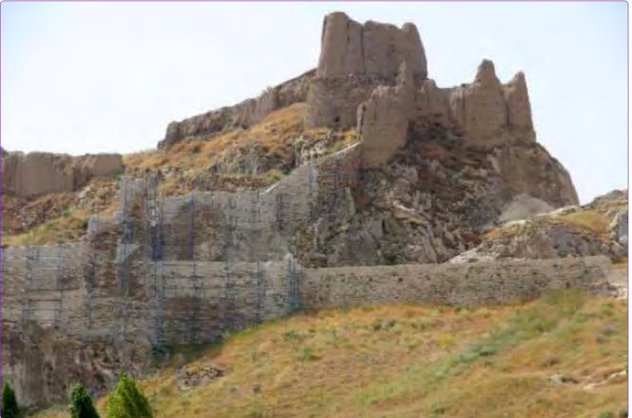
Şekil 18. 2013 yılında uyumsuz bir derzleme işçiliğiyle tümlenmiş duvar yüzeyleri.
