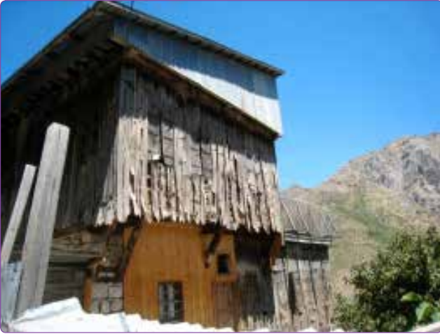
Şekil 8. Düşey ahşap kaplı cephelerde oluşan bozulmalar.
