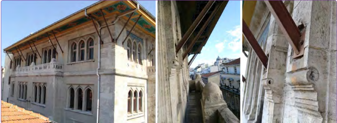
Şekil 24. Binanın saçağı ve destekleyen çelik payandalar.
