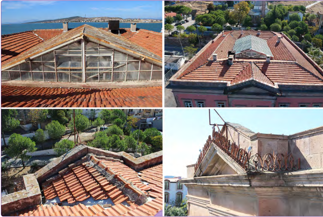
Şekil 12. Ahşap kırma çatı, cam ışıklık ve giriş cephesi üzerindeki üçgen alınlığa ilişkin detaylar.
