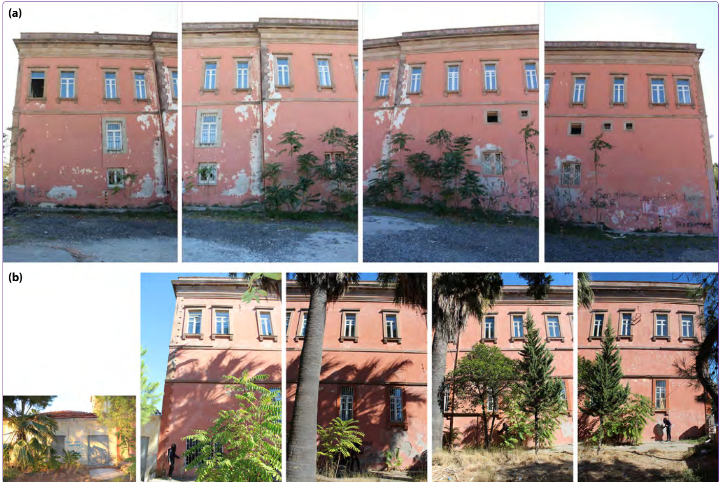
Şekil 18. Doğu (a) ve batı (b) cephesinde sonradan açılmış-değiştirilmiş pencere boşlukları.
