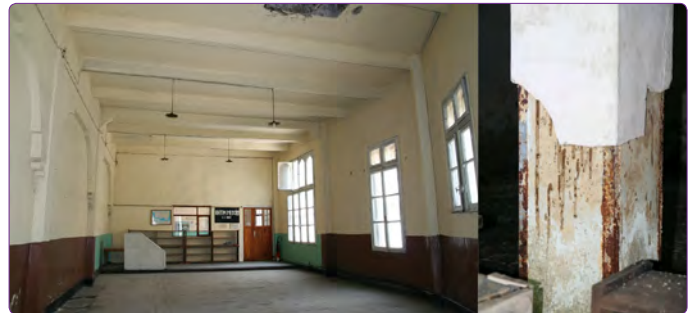
Şekil 13. Galata Rüşumat Binası, Hennebique Betonarme taşıyıcı sisteme ait kolon, kiriş ve döşeme düzenleri (Banu Çelebioğlu).
