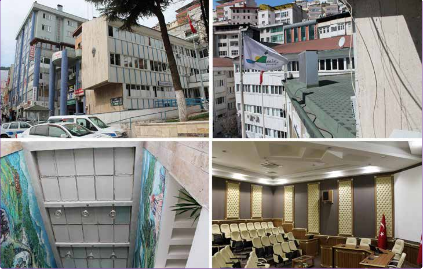
Şekil 30. Yapı ve yakın çevresindeki niteliksiz ek ve onarımlardan örnekler: Sol üstte Emniyet Müdürlüğü'nün yanındaki parselin yapıyla kurduğu ilişki, sol altta kapatılmış aydınlık pencereleri, sağ üstte değiştirilen çatı kaplama malzemesi, sağ altta tavan yüksekliği ve özgün mobilyaları değiştirilen konferans salonu (Güler, 2015).
