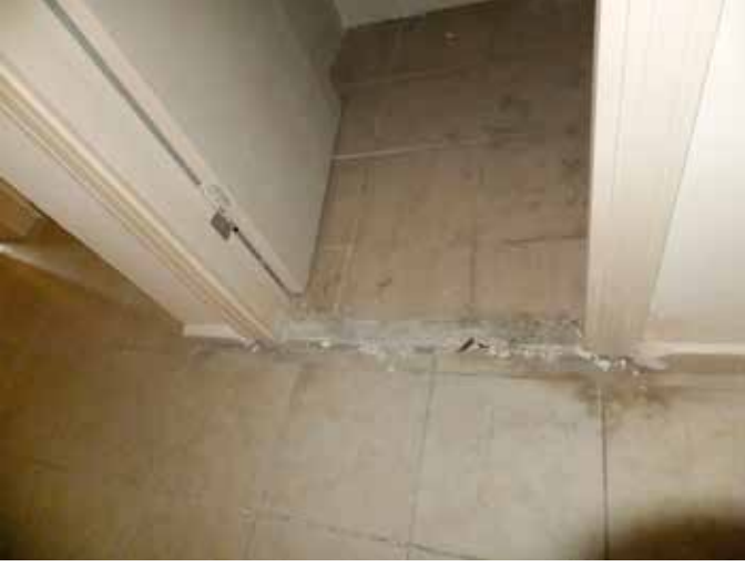
Şekil 16. Uygulamada yapım kalitesini düşüren işçilik sorunları.
