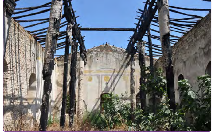
Şekil 22. Apsisin yıkılıp düz duvara dönüştürüldüğü doğu cephesi (2015) (S. Giray Küçük).
