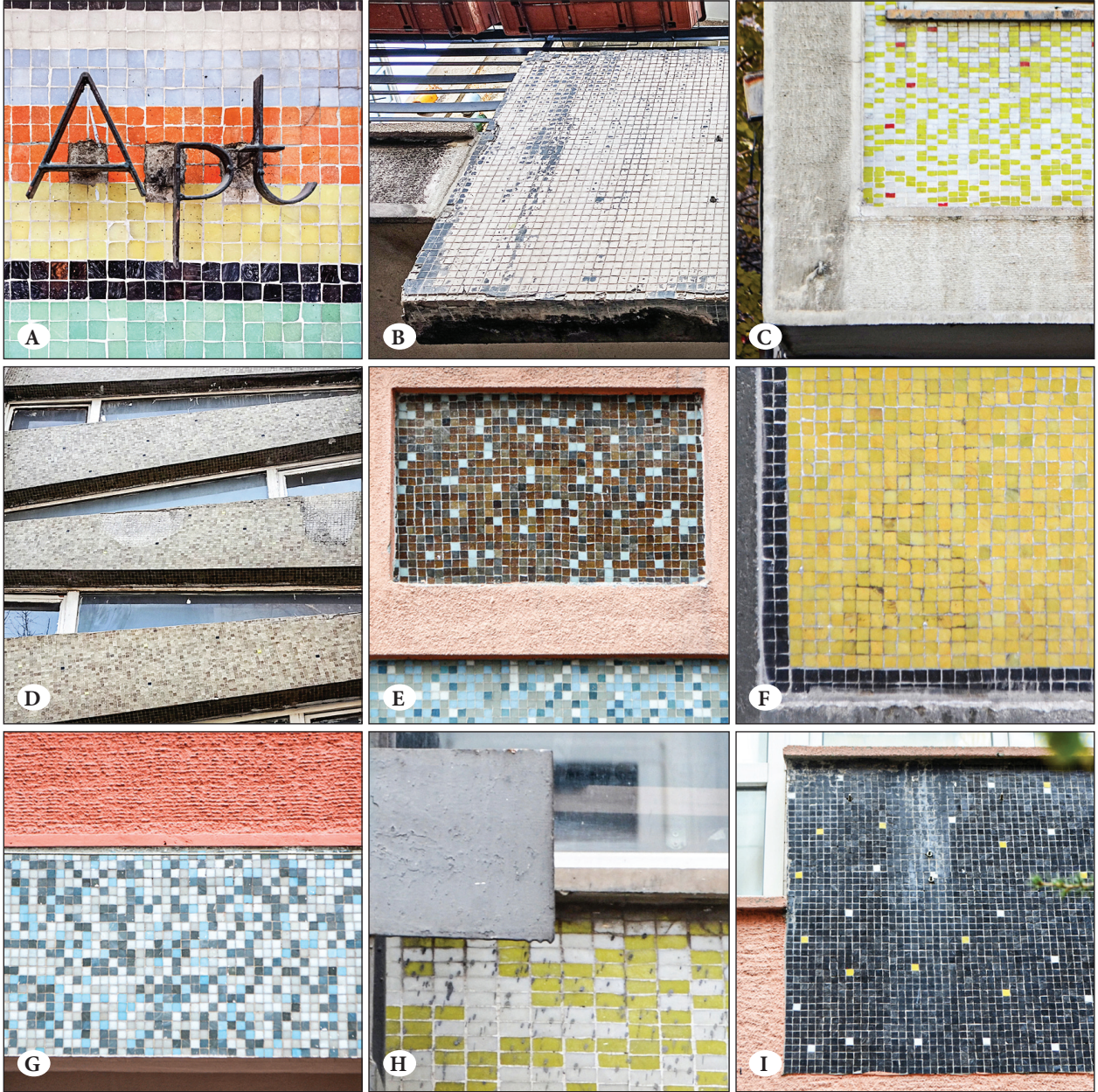
Şekil 6A, 6B, 6C, 6D, 6E, 6F, 6G, 6H ve 6I. Smalti tekniğiyle üretilmiş cam mozaik kaplı Ankara apartmanlarına ait fragmanlar. 14 Fotoğraf: Araştırma ekibi, Kasım, Aralık 2024.
