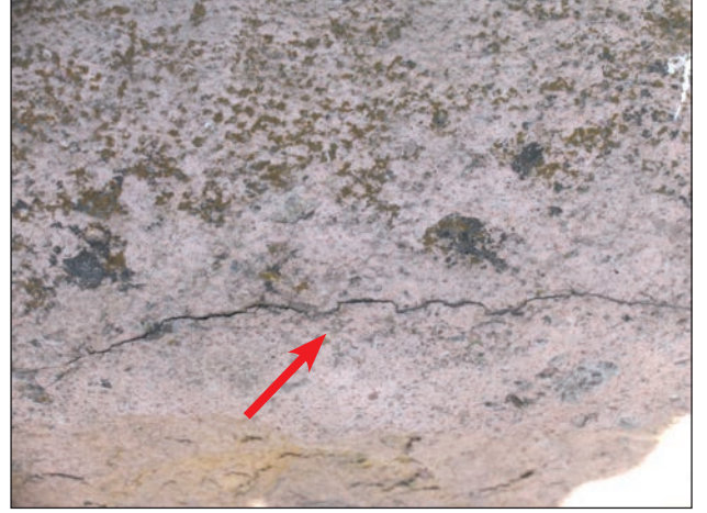
Ek 13. Çatlak, yarık ve kırıklar.
