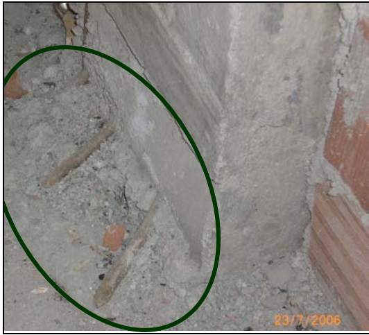
Şekil 14. Kütahya, Emet İÖO binasında kolon kesit daraltması, (Kaplan ve ark., 2006b).
