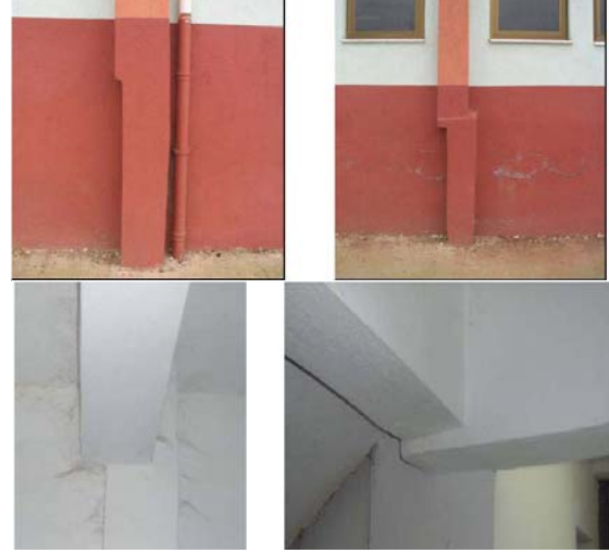
Şekil 12. Muğla ilinde farklı kamu yapılarında karşılaşılan işçilik hataları.
