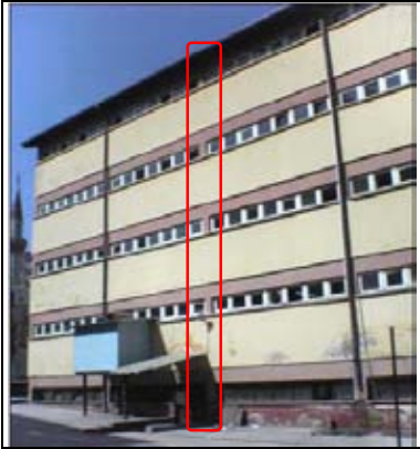
Şekil 18. Denizli Lisesi Pansiyon binası, kısa kolon uygulaması (Kaplan ve ark., 2005a).
