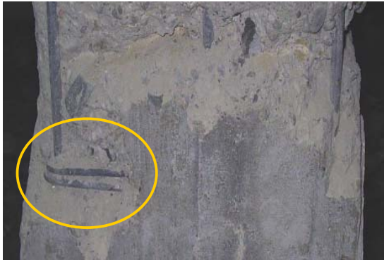
a) Denizli Eski SSK Hastanesi poliklinik binasında kolonda etriye uygulaması, (Kaplan ve ark., 2006a).
